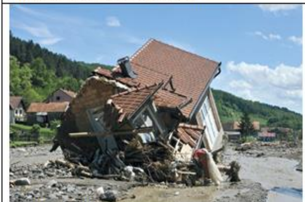
Klizišta srušila kuću
